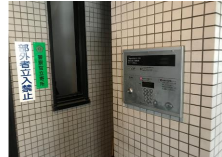
セキュリティ設備
