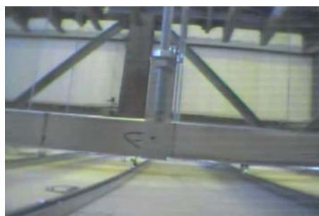
Figure 11 検査ロボットから損傷箇所の映像
